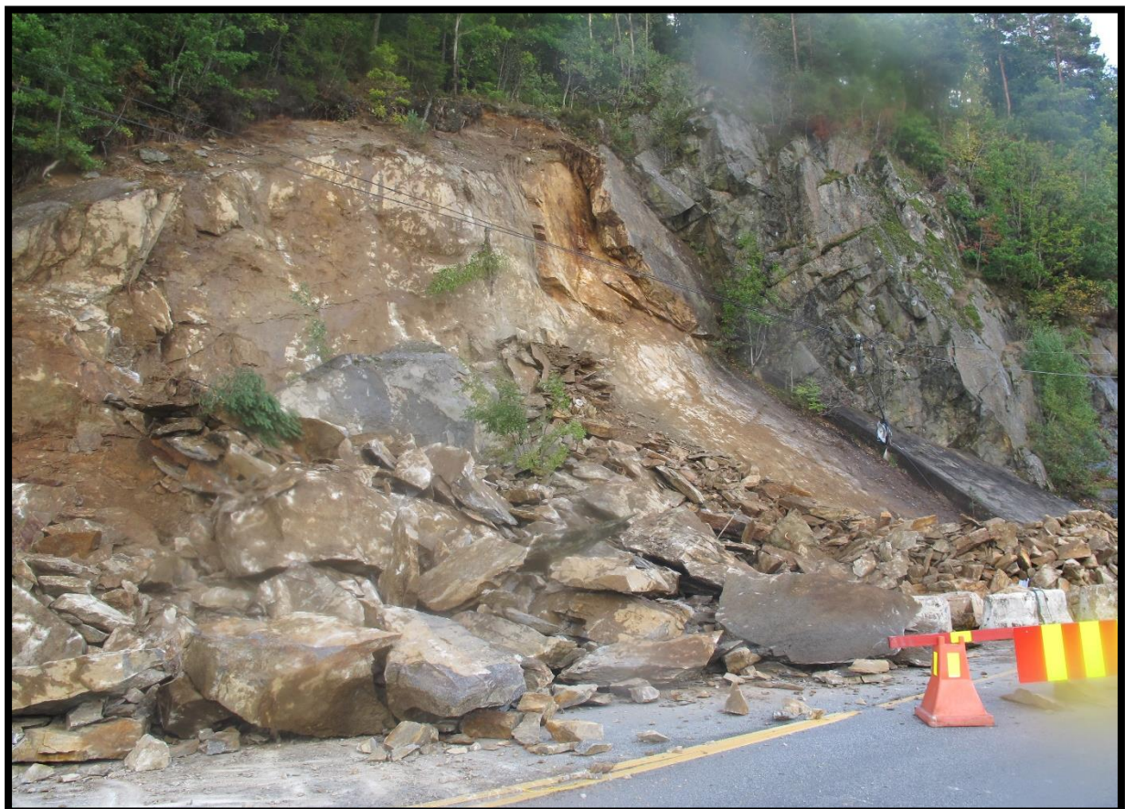
Figur 17. Bergskjæring pr. 30-60 etter nedfall.
