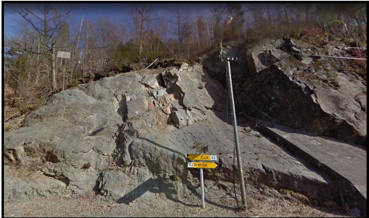
Figur 16. Bergskjæring pr. 30-60 før nedfall.
